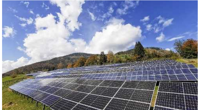
Abb. 39: PV-Freiflächenanlage (Quelle: PULSE Engineering GmbH, https://www.pulse-eng.com/projekte/photovoltaik-freiflaechenanlage-lesachtal )
